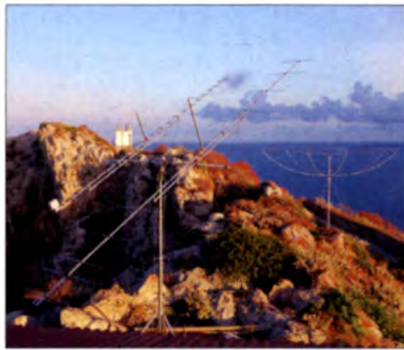
Bild 3: Die Antennenanlage mit zwei Langyagis für EME-Betrieb (links) und einem Hexbeam (rechts)
