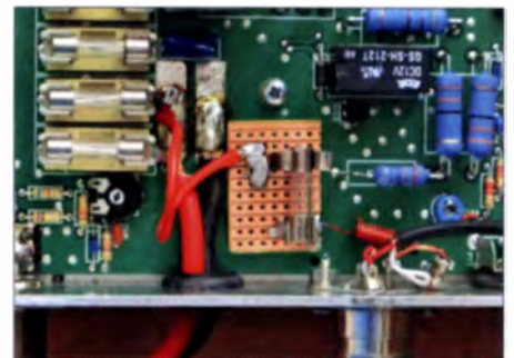
Bild 3: Rückwand mit Flanschsteckdose und Vorsicherung auf einer kleinen Sub-Platine
